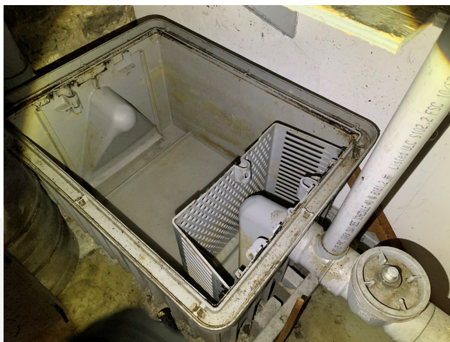
Exemple de trappe nettoyée.
